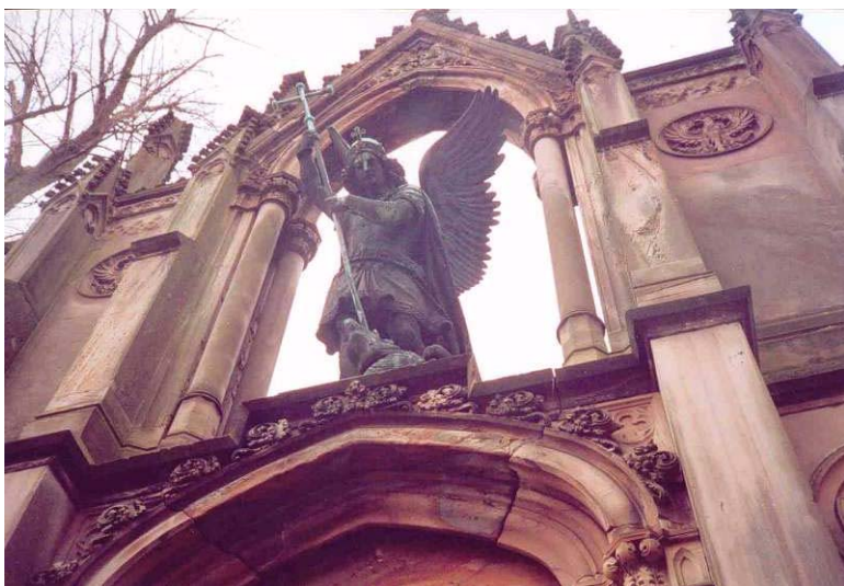
7.6 Oplakany stan kamienia ołtarzowego z 1849 roku robi wrażenie zawalenia się - wraz z rzeźbą Kissa!
